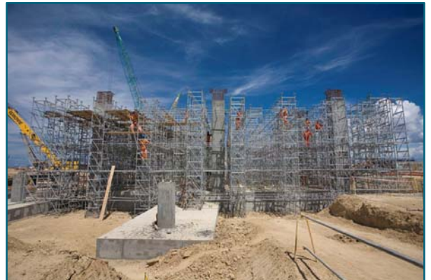
LNG Plant - Condensers
