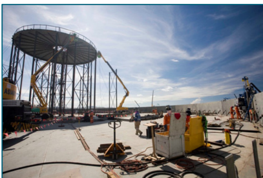
LNG Plant - LNG storage
