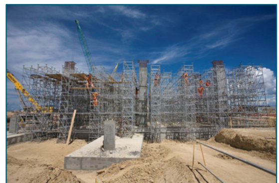
LNG Plant - Condensers
