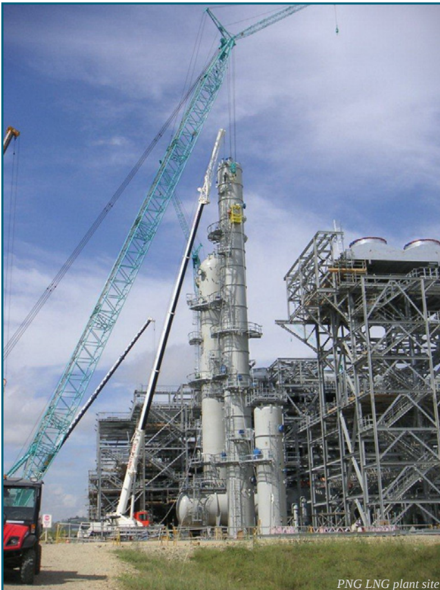
PNG LNG plant site
