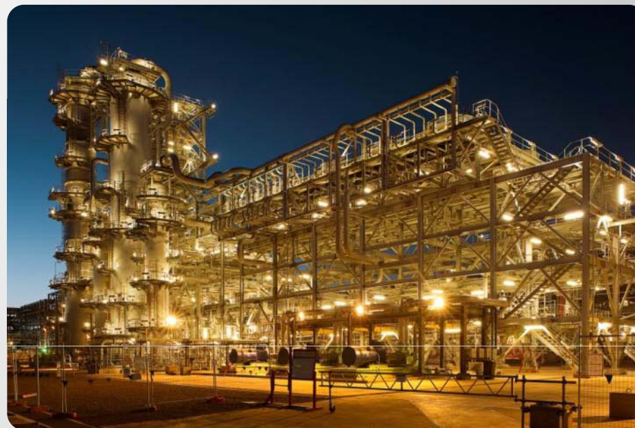
Pluto LNG plant
