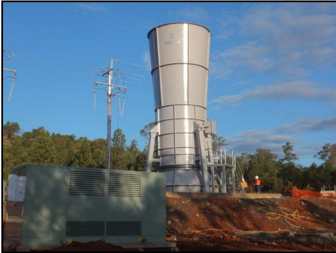
Primary vent fan
