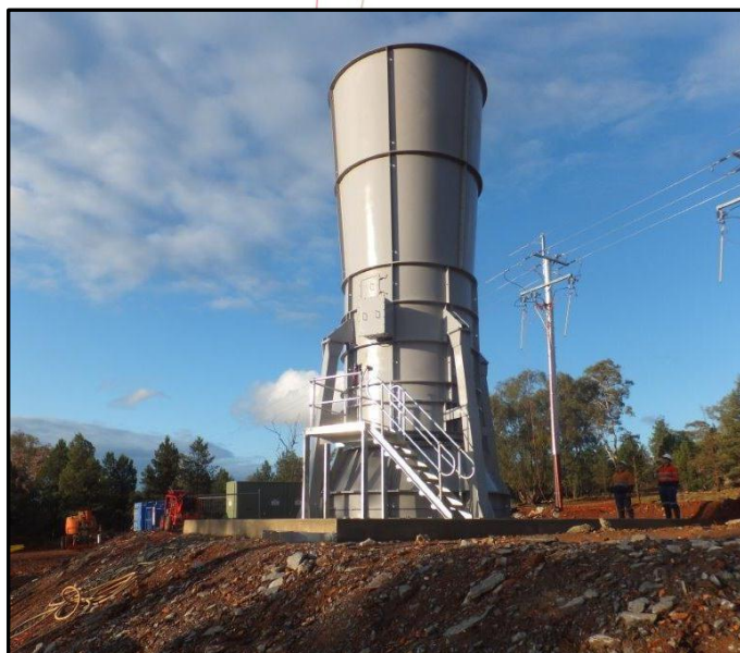
Primary Vent Fan
