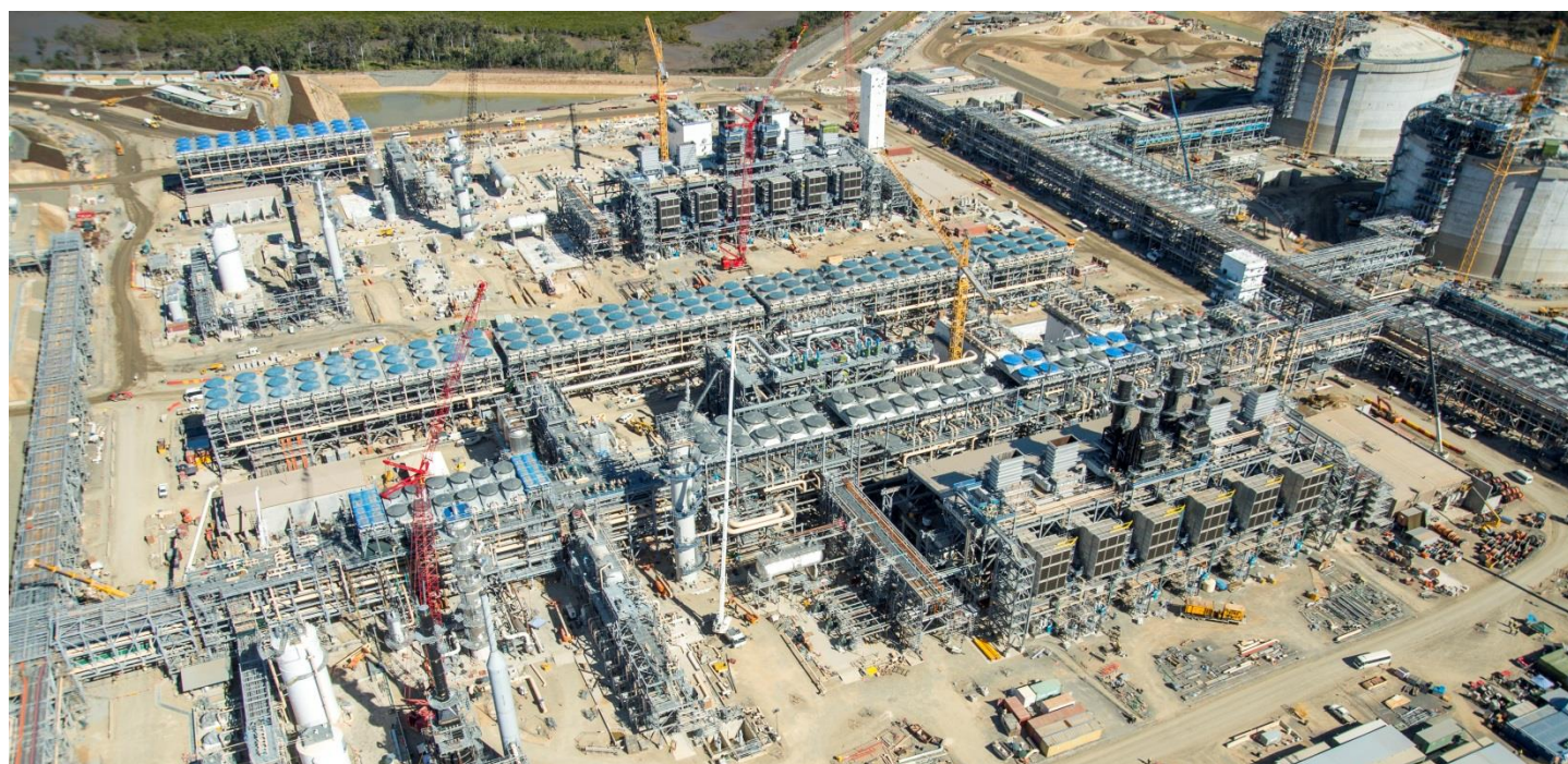
LNG trains, Curtis Island, July 2014.
